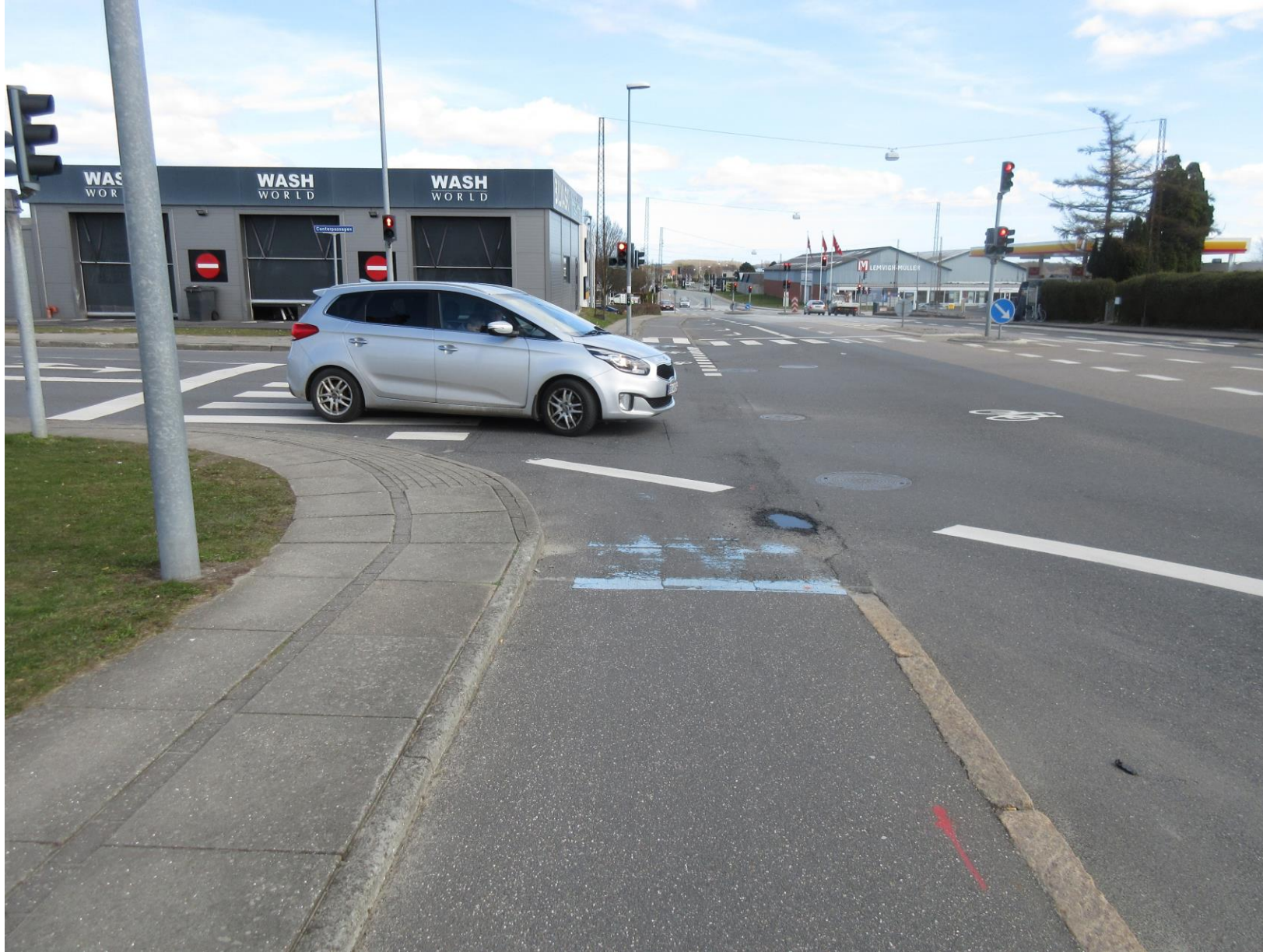
Manglende vedligeholdelse af den blå cykelbanemarkering på Alsgade.
